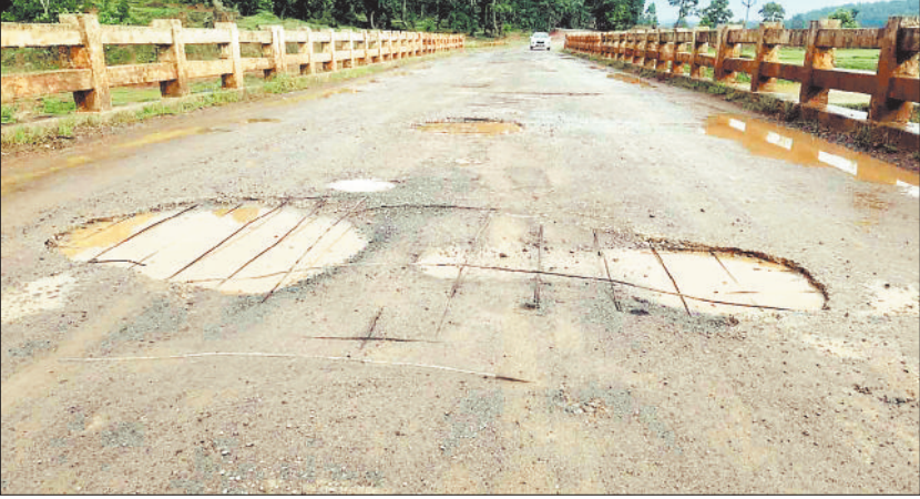
जर्जर पुल के गड्ढे से निकले सरिया।
